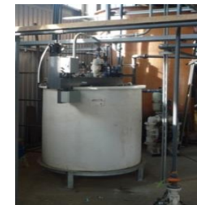
Сборник стоков участка химического травления металла
